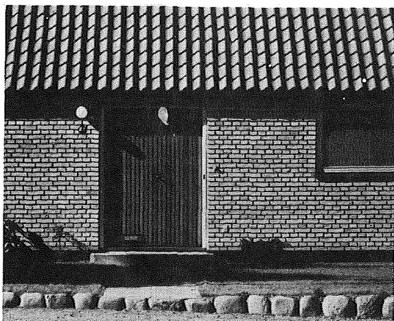
Ubehandlet facademur med fugning.
